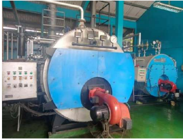
Gambar 25. Mesin Boiler (Pemanas)
