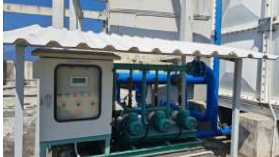
Figure 1. Kolam Penampungan Air di Rooftop dan Pompa Booster
