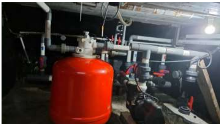
Figure 2. Pompa Penyalur Air Kolam Renang
